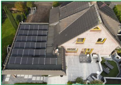
19 Module – Süd-West Ausrichtung – 6,937 KWp
